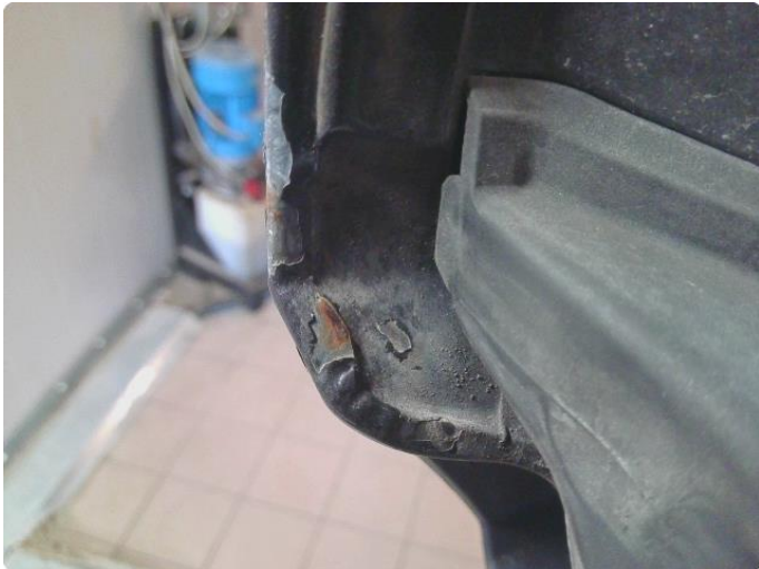
1.1 Rust i fals
