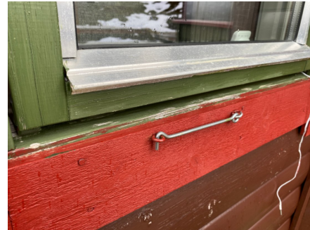
Værslitt og mangler beslag under vindu
