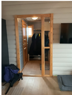
Mangler dørblad mellom vindfang og stue
