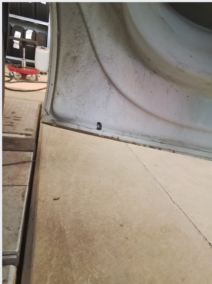
2.5 Rust nedre del dører bs foran
