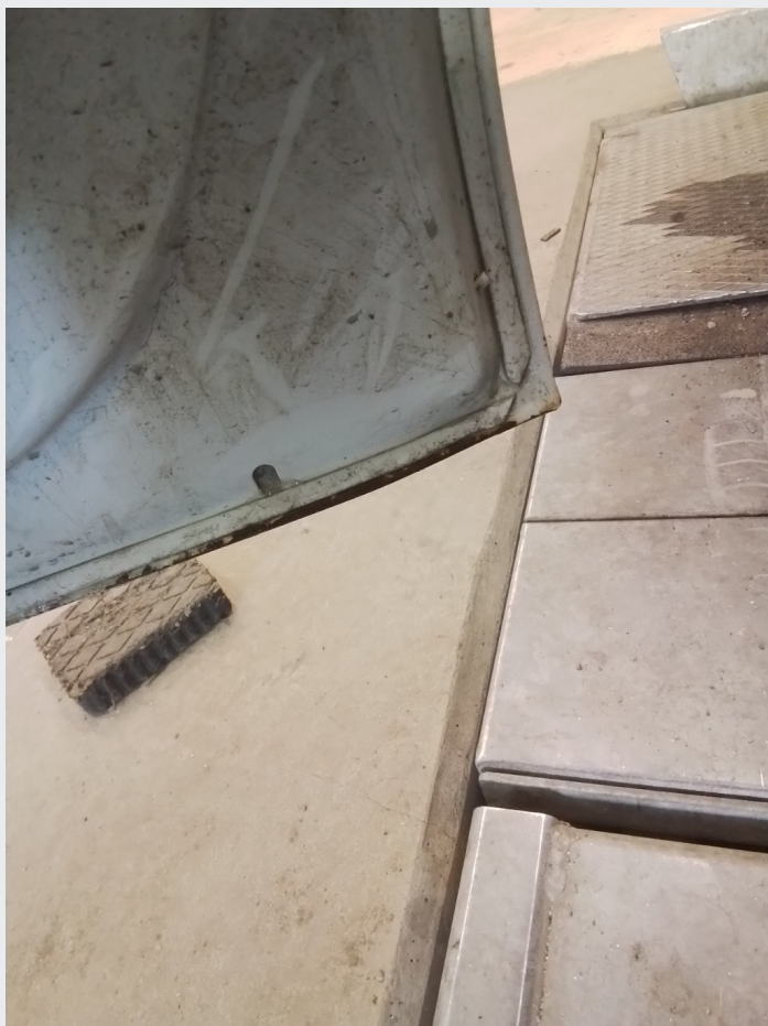
2.5 Rust nedre del dører bs foran
