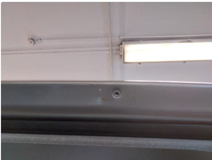
2.21 Rust på takk
