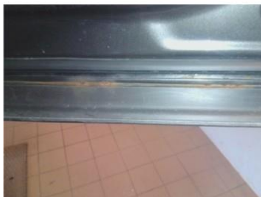
1.3 Rust i fals
