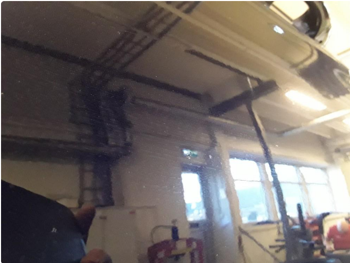
1.2 Steinsprut med korrosjon venstre fordør.
