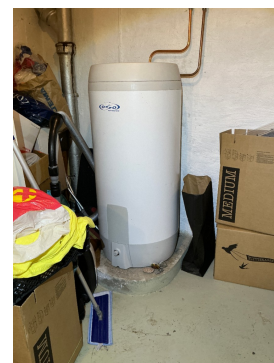
Varmtvannstank i vaskerommet
