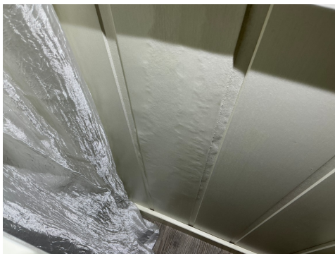
Svellinger på veggoverflate under vindu på soverom
