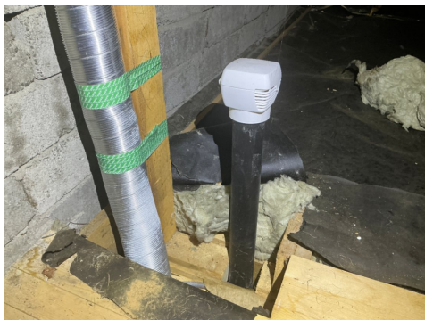
Avløpslufting avsluttet på kaldloftet
