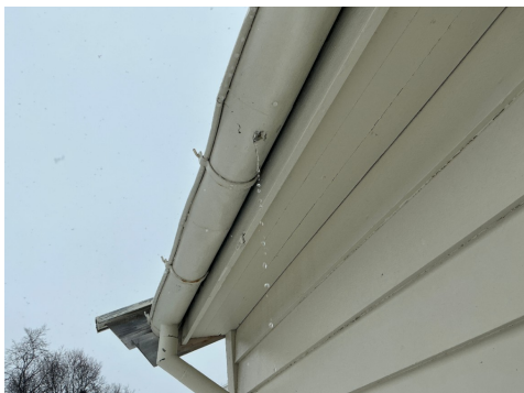
Lekkasje i takrenne over inngangsparti
