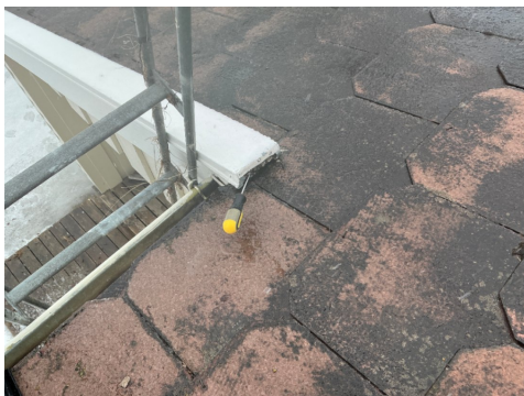
Råteskader i vannbord
