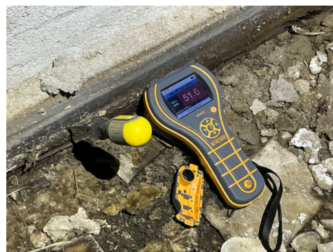
Fuktig og råteskadet trevirke
