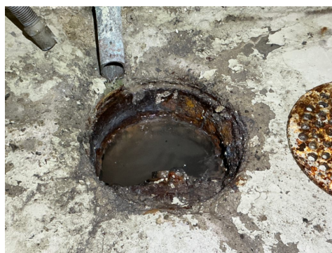
Sluk i gulv under skyllekaret
