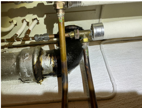
Korrosjon på kobberør
