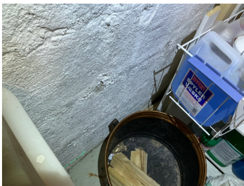
Saltutslag og avflassinger på betongvegg mot nord
