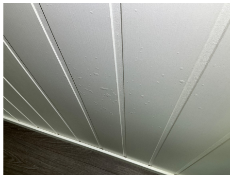
Svellinger på veggoverflate i stue
