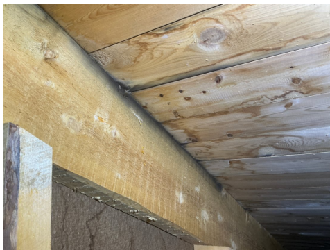
Misfarginger i undertak og takspærre
