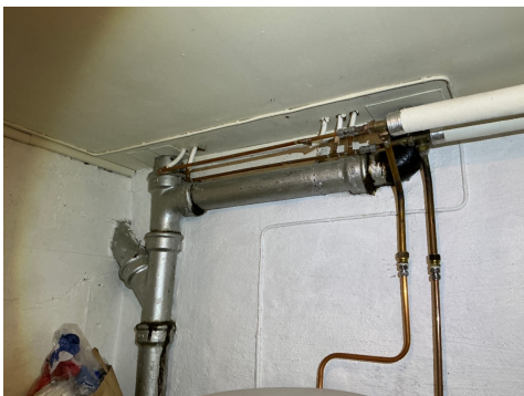
Avløpsrør i kjeller
