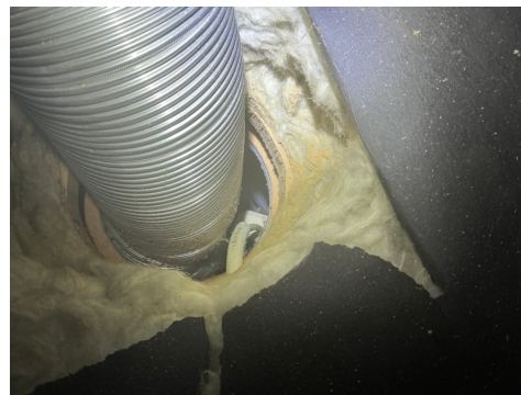
Utette gjennomføringer fra oppvarmet rom under
