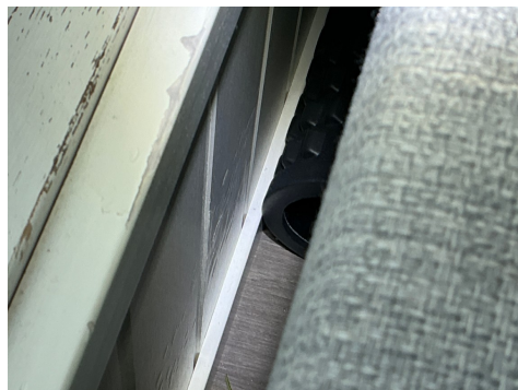
Svellinger på veggoverflate under vindu i stue
