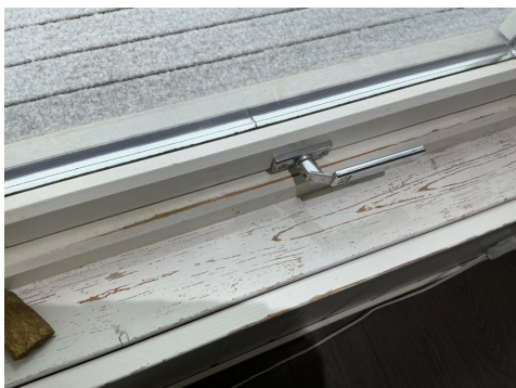
Slitasje på innvendige karmer/foring/listing i stue
