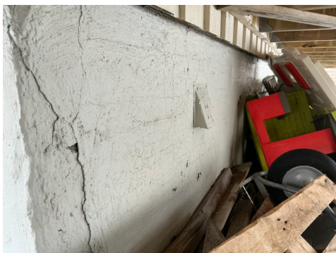
Sprekker i grunnmur
