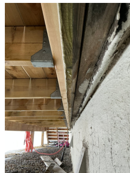
Lite lufting i nederkant av kledningsbord
