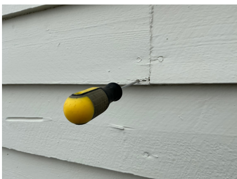
Råte i kledningsbord
