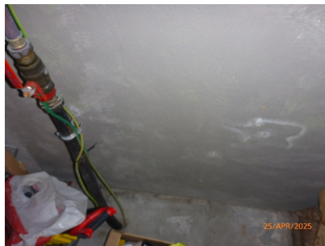
Fetts stoppekran på bod
