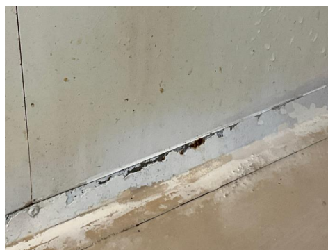
Utett overgang mellom vegger og gulv, samt rustdannelser i området
