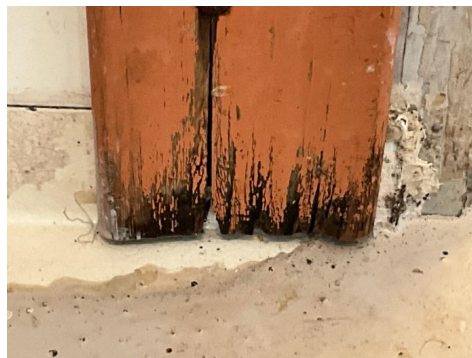
Råteskadet trelist rundt dør
