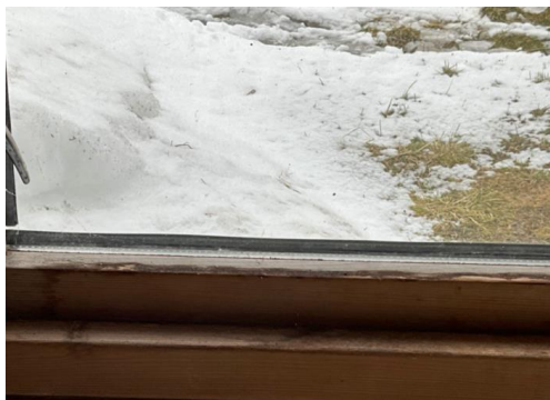
Fuktmerker i vindu
