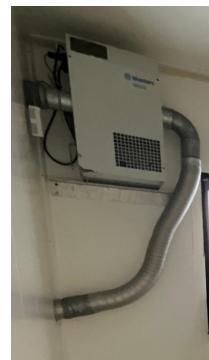
Tørkeanlegg installert i tilliggende rom
