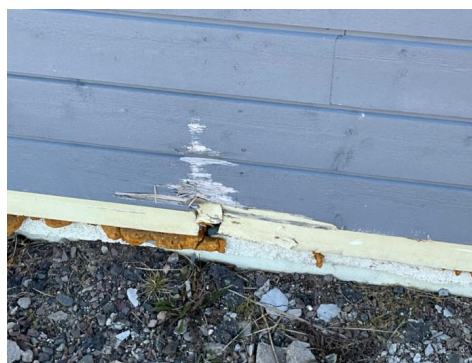
Skade i nederkant av utvendig kledning
