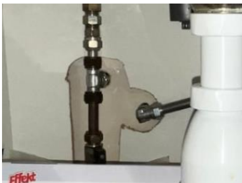
Rørgjennomføringer under servant
