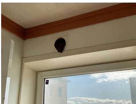
Tettet ventil i yttervegg
