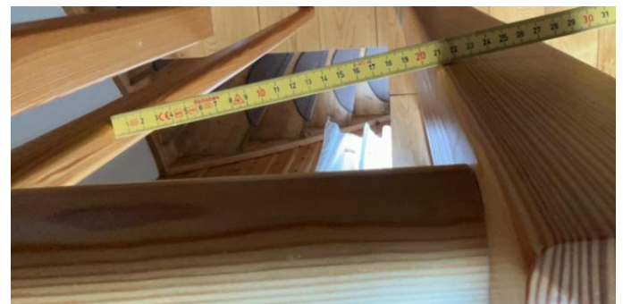
Åpninger i rekkverket
