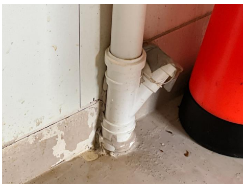
Avflassing på gulvet
