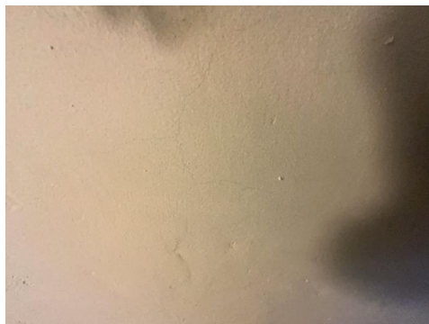
Sprekkdannelser i pipen
