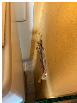
Sot-/feieluke i produksjonslokale. Tydelige sprekker i pipe
