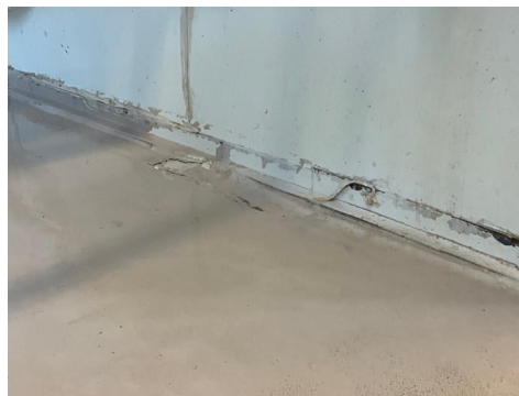
Fuger i nederkant av veggplater
