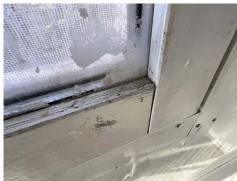
Trevindu med oppsprukket maling
