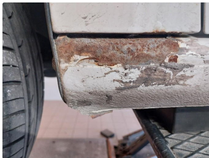
1.18 Rustne kanal v.s
