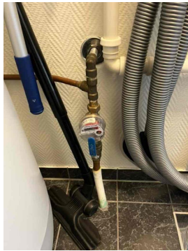
Vanninntak med vannmåler og stoppekran.
