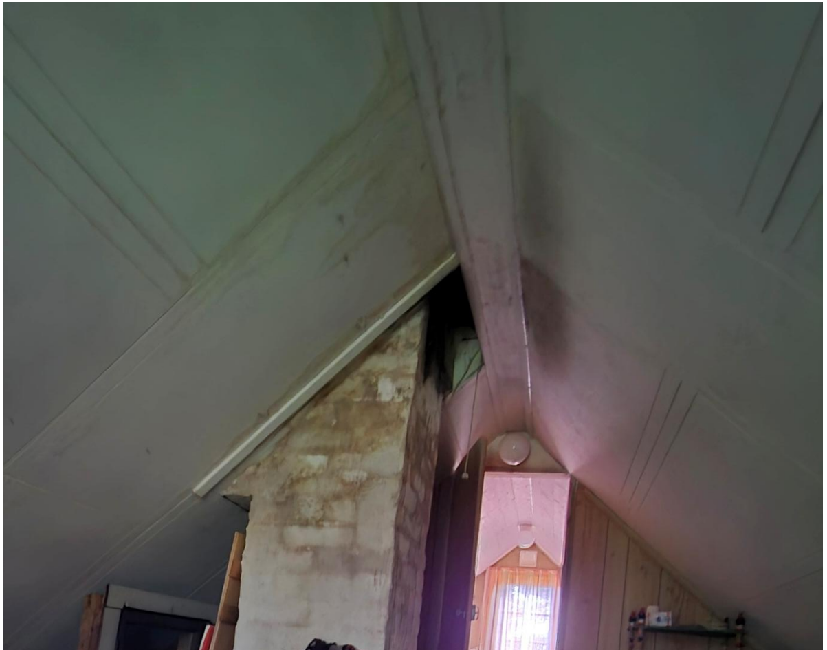
Tak og pipe i første loftsrom (bilde tatt mot nord) med spor etter vannskade
