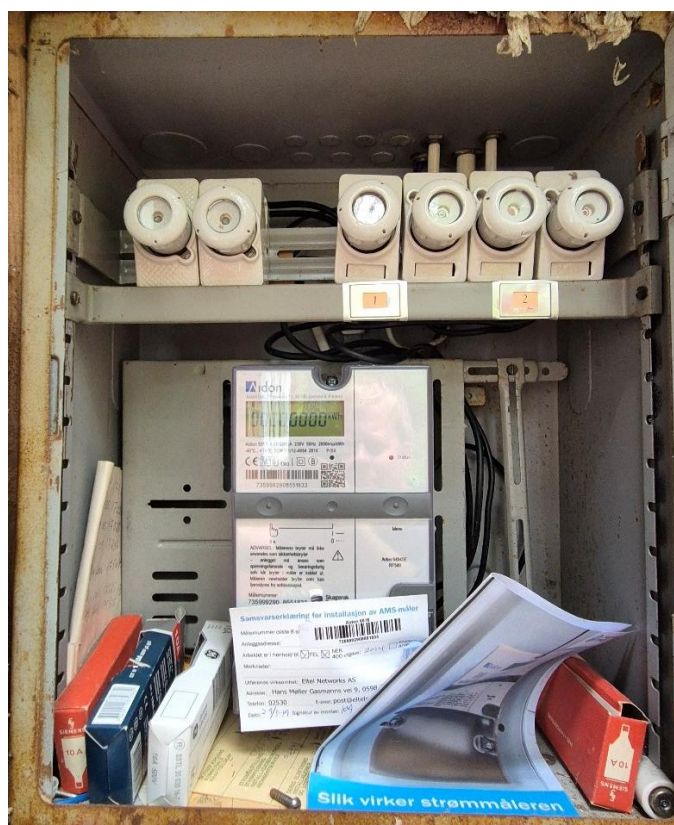
Sikringsskap med ny måler – og «gamle» kurser
