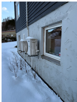
Manglende innsetningsdetaljer rundt vindu i underetasje.
