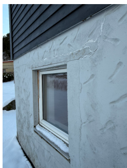
Sprekk i murpuss i området rundt vindu
