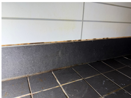
Misfarging/svertesopp i silikonfuger
