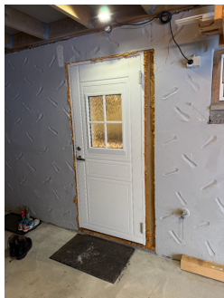
Ytterdør til underetasje: Manglende innsettsdetaljer.
