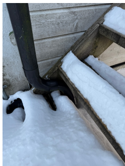
Nedløpsrør for taknedløp er ikke tilkoblet rør i grunnen.
