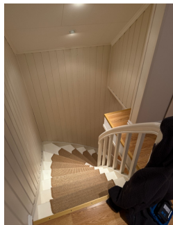
Trapp sett fra loft, manglende rekkverk på høyre side.
