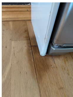
Fuktskjolder i parkett ved kjøleskap.
