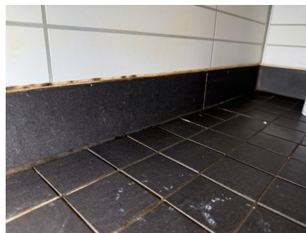
Misfarging/svertesopp i silikonfuger
