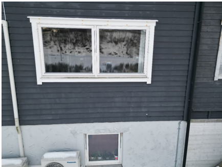
Rustet spiker på omramming av vindu, værslitt vannbrett.
