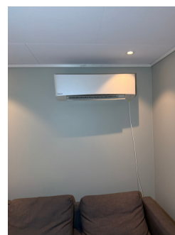
Innedel varmepumpe stue underetasje
