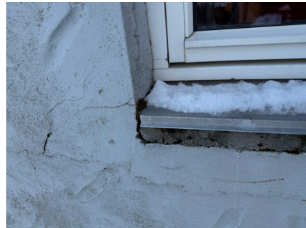
Beslagsløsning om innsetningsdetaljer bør utbedres for å forhindre videre utvikling av sprekker i betongpuss.
