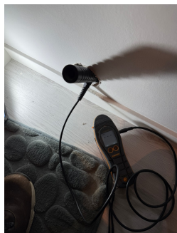
Fuktmåling fra gang mot dusjsone.
