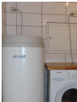
Varmtvannsbereider inne på vaskerommet.
