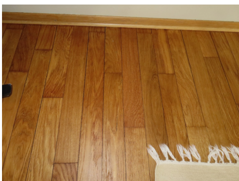
Parkettgulvet ses med fuktneddrekk i kjøtene.
