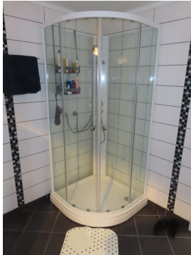
Frittstående dusjkabinett (nyere kabinett ihht eier).
