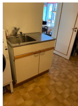
Skapinnredning i grovkjøkken.
