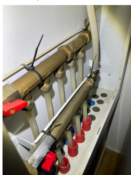
Rør i rørskap i grovkjøkken til badene med stoppekraner.
