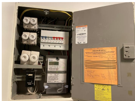
Skap i felles trappegang.
