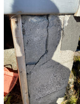
Sprekk i mur ved innspeksjonsluke
