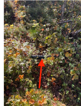
Vannrør ligger oppå terreng mellom brønnhus og hytte
