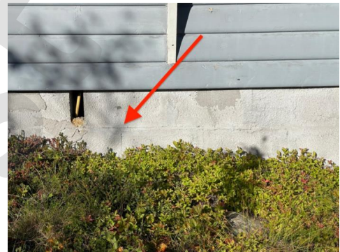
Sprekker og riss i mur
