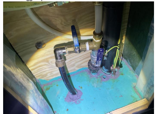
Vanninntak i veggskap
