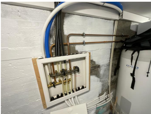
Fordelingskap for vann
