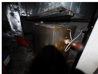
Ventilasjonsanlegg som ikke har vært i bruk
