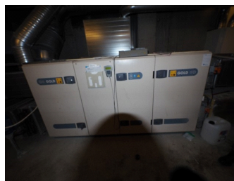
Ventilasjon anlegg som er i daglig bruk.
