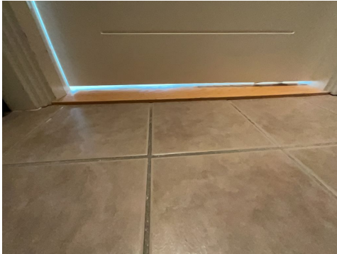
Spalte mellom dørrblad og dørrterskel.
