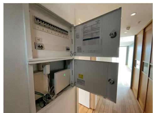
Fordeleskap og IT-skap.
