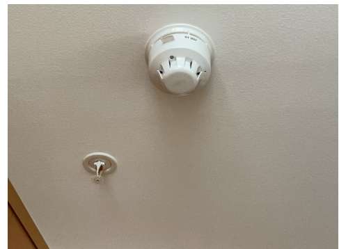
Røykdetektor tilknyttet brannsentral. Sprinklerhode.
