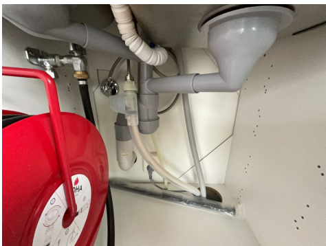
Utsnitt av avløpsrør i kjøkkenbenk.
