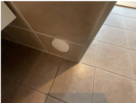
Lekkasjesikring ("siklemikk") for fordelerskap til rør i rør-installasjon.
