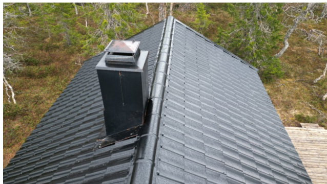
Manglende takstige til pipe.
