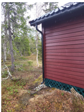
Nedløpsrør er ikke tilkoblet overvannsrør
