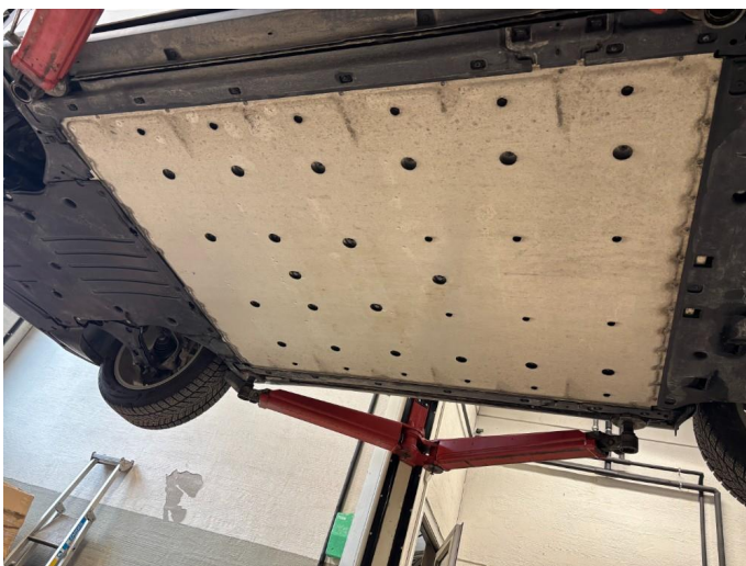
2.1 Ingen skader batteri
