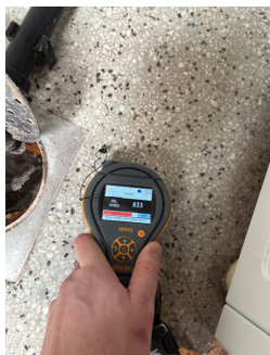
Det er forhøyede fuktindikasjoner i gulv rundt sluk.
