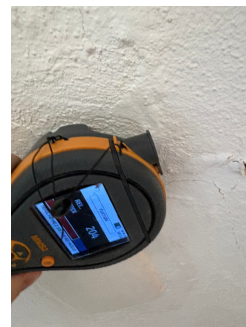
Det er avflassing og oppsprekninger i himling.
