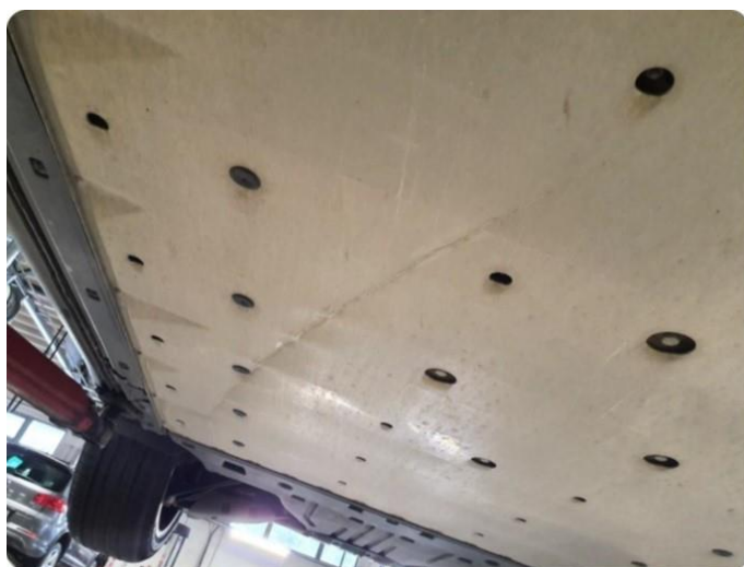
1.2 Beskyttelsesplate skadet/mangler. Liten bulk og lånyt ripe på batterideksel. Ikke nødvendig å skifte.
