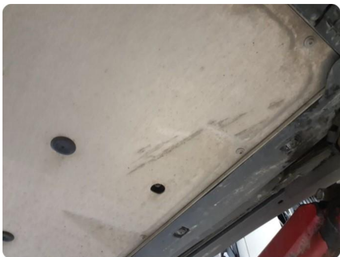
1.2 Beskyttelsesplate skadet/mangler. Liten bulk og lånyt ripe på batterideksel. Ikke nødvendig å skifte.
