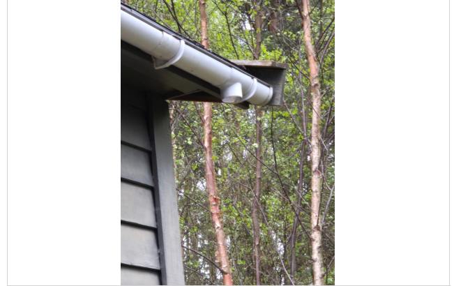
Plast takrenner. Mangler nedløp.
