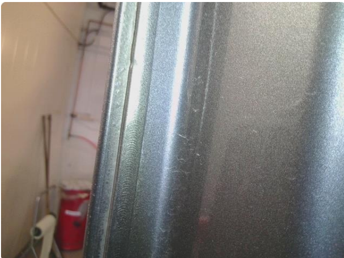
1.1 Rust i fals
