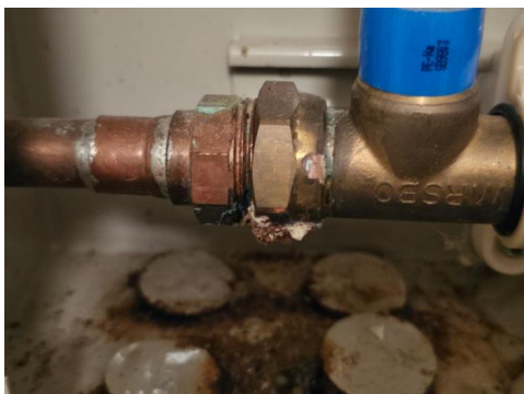
Svetteing/lekkasje i rør-i-rør i sokkelen
