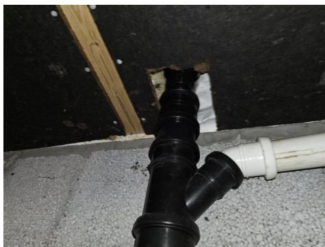
Synlig åpning rundt sluk i stubbeloft
