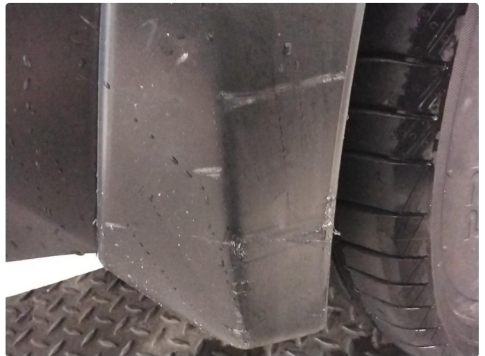
1.3 Riper i skvettlapp høyre side bak.
