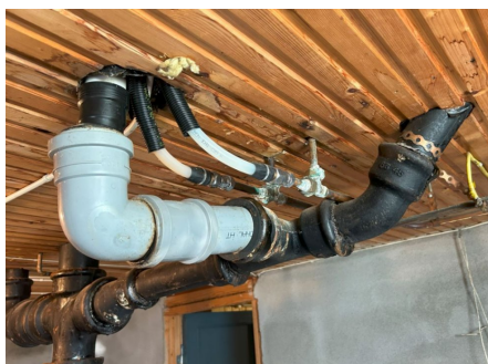
Rør i rør påkoblet i kjeller og opp til kjøkken.
