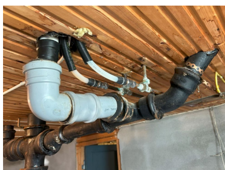
Motfall avløp i vaskerom kjeller
