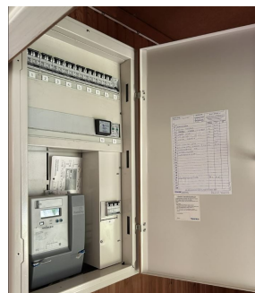
Sikringsskap plassert i trappegang.
