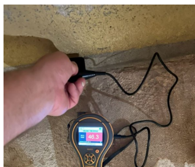
Målt fukt på vegg i kjelleretasje.
