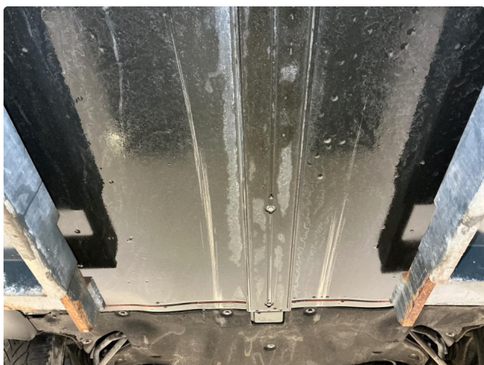
3.1 Ripper / skrape i plate under batteri - ok
