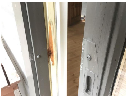
Skader i skyvedørs karm
