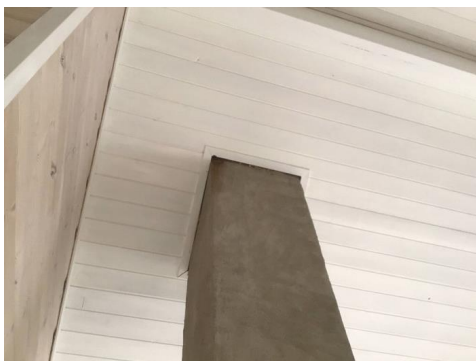
Fukt merker under tak ved pipe
