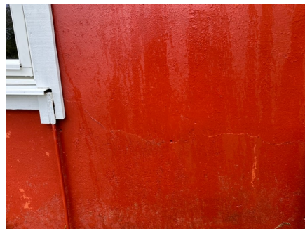
Grunnmuren har sprekkdannelser.
