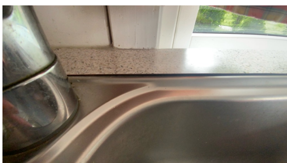
Fuktskade i benkeplate..
