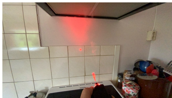
Funksjonstest av ventilator. Ok.
