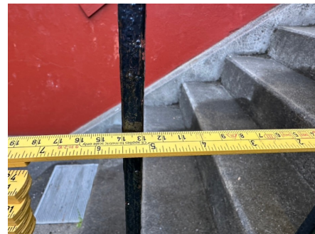
Åpninger i rekkverket på over 10cm.
