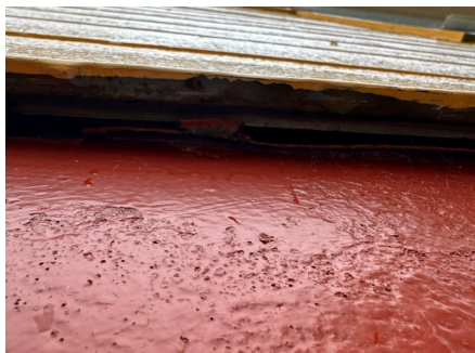
Ingen lufting av kledning mot sør.
