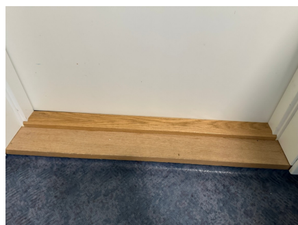
Mangler tilluft under dør.
