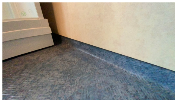
Det er ikke montert bunnlist i våtsoner
