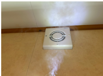
Avtrekksvifte startet ikke ved befarings.
