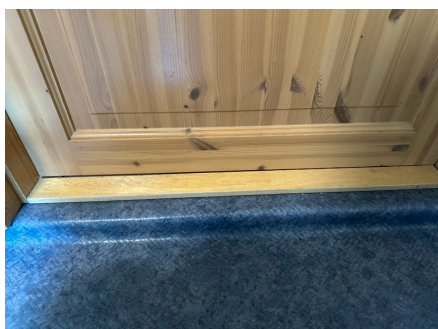
Mangler tilluft under dør.
