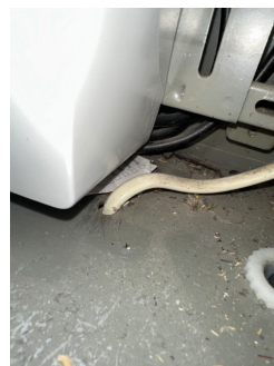
Ikke benyttet mufte ved gjennomføring.
