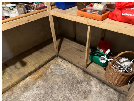
Saltutslag på gulv og vegger, råteskadet reoler.
