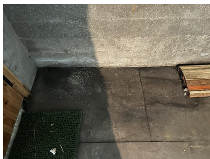
Råteskadet plater på deler av gulv i kjeller.
