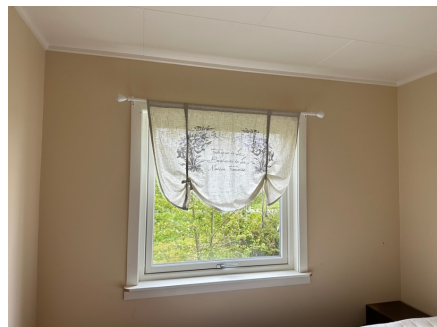
Ingen ventilerings utover åpning av vindu på soverom
