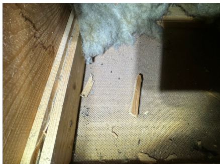
Muselort og manglende isolasjon.
