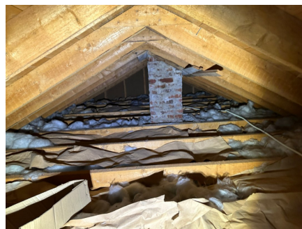
Ikke gangbart gulv ved tilbygg.
