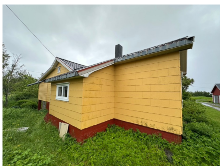
Ingen lufting av eternit kledning.
