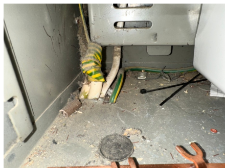
Ikke benyttet mufte ved gjennomføring.
