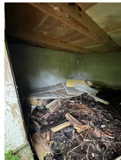
Ingen ventilering eller fuktsperre på grunnen
