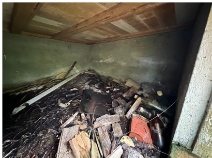
Ingen ventilering eller fuktsperre på grunnen
