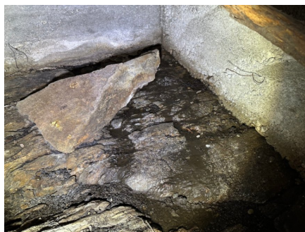
I deler av kjeller med lav takhøyde er det synlig vann på berget.
