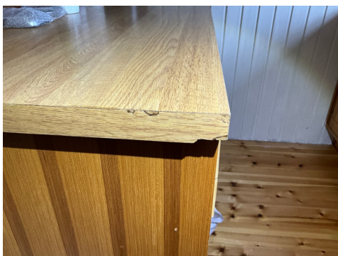
Skade i benkeplate
