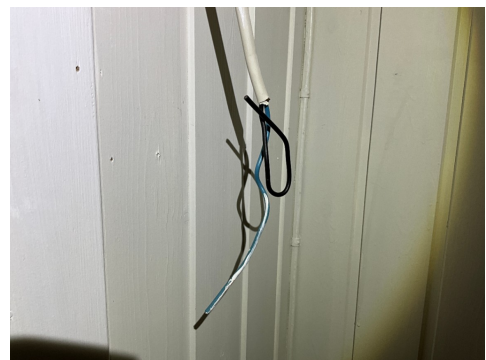
Løse og uisolerte ledninger
