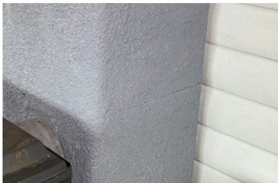
Sprekk i pipen
