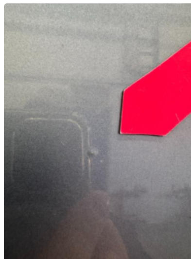
1.2 Liten steinsprut med korrosjon venstre fordør.
