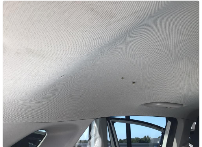
2.1 Noen merker/rifter i taktrekk venstre side bak
