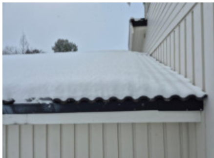
Betongtakstein over utebod.
