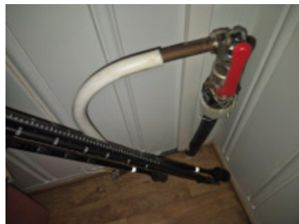
Innvendig stoppekran i bod i underetasjen.
