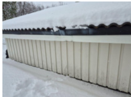
Kan se ut som et par stein ved takfot mangler og/eller er skadet.
