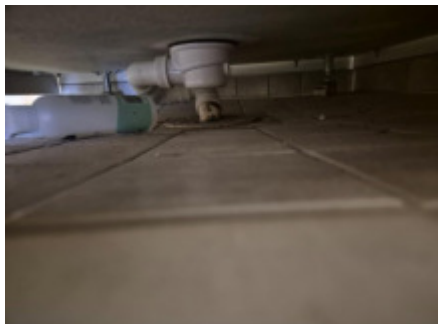
Sluk under dusjkabinett.
