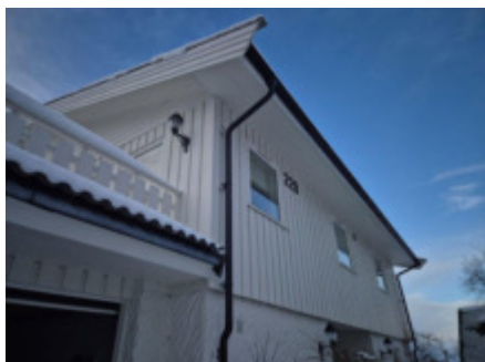
Takrenner og nedløpsrør i stål.
