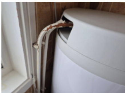
Innvendige vannledninger av kobber.
