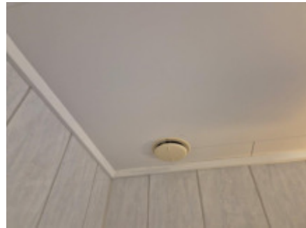
Ventil i innvendig tak.
