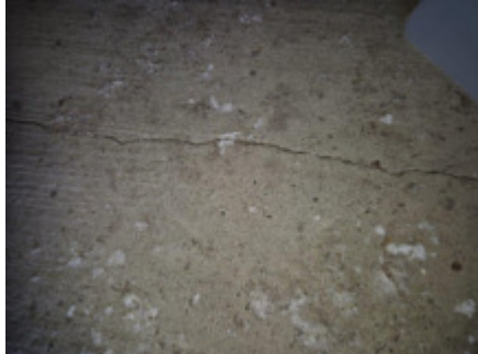
Sprekkdannelse i betonggulv i garasje.
