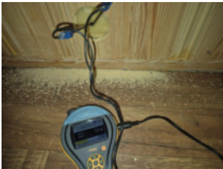
Målinger i utforet vegg viser gult nivå (risiko for fukt).
