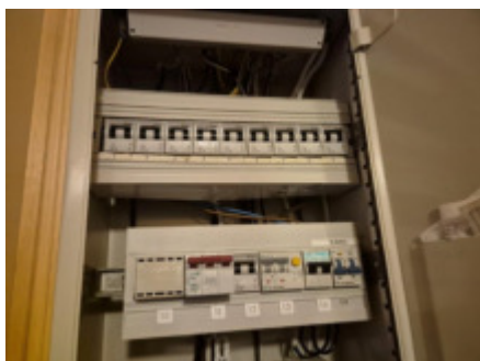
Sikringsskap med automatsikringer.
