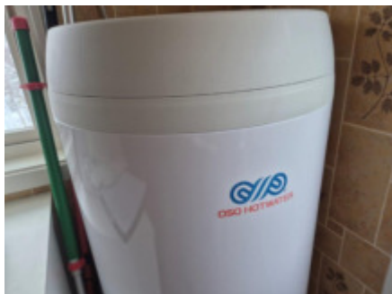
Varmvannsbereider i vaskerom.
