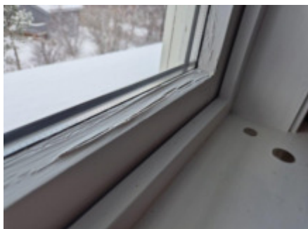
Oppsprekking av maling i vinduskarm.
