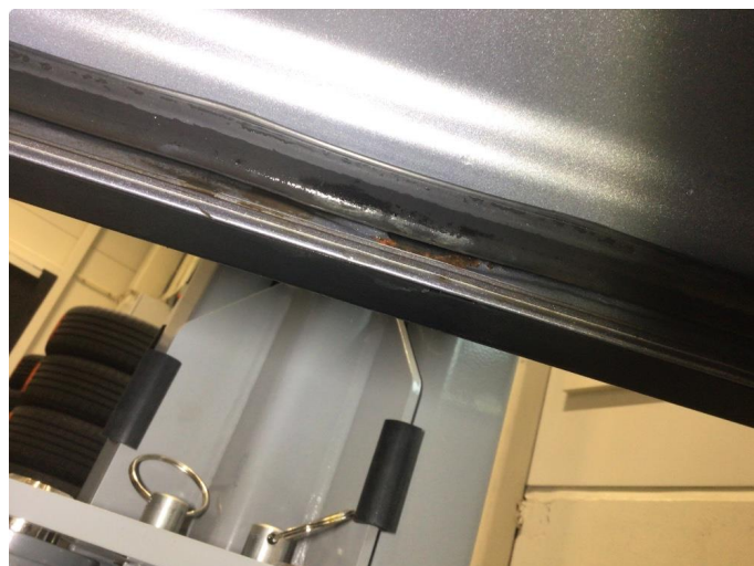
1.2 Noe korrosjon i fals på alle dører
