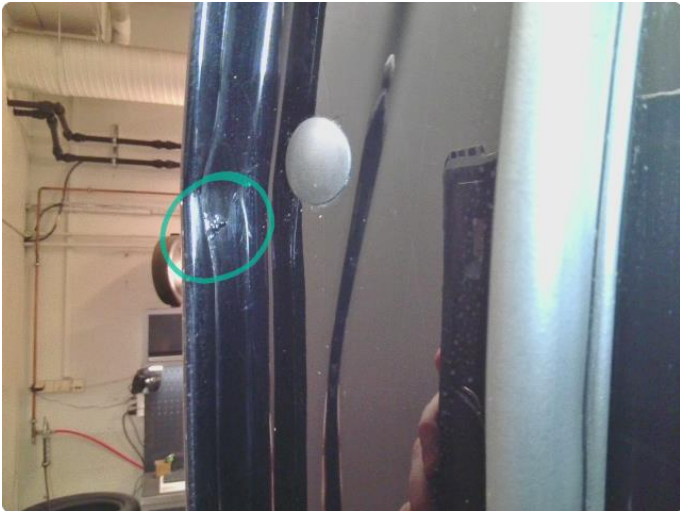
1.1 Rust i fals
