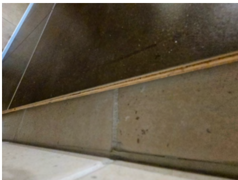
Ingen tetting i nedre kant av baderomsplatene
