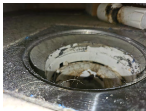
Membran er ikke klemt i slukring i sluk
