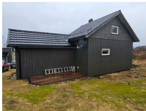
Braketter på tak etter tidligere solcellepanel.
