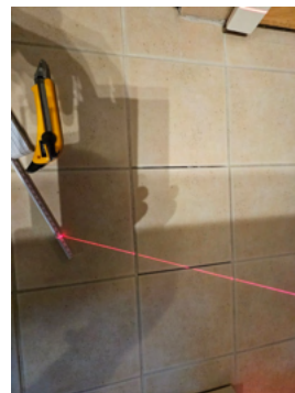
Manglende fugemasse rundt fliser, bom i flis
