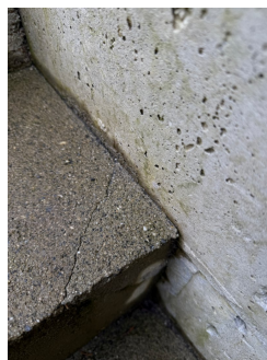
Sprekke i trinn på utvendig betongtrapp
