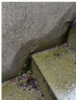
Avskaling av puss, lite overdekning
