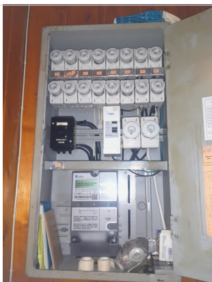
Sikringsskap med skrusikringer fra byggeår.
