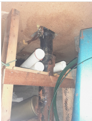
Kobber vannrør og soil avløp.
