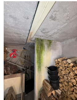
Fuktskjolder fra dekket, synlig armering. Synlig armering må tettes tildekkes.
