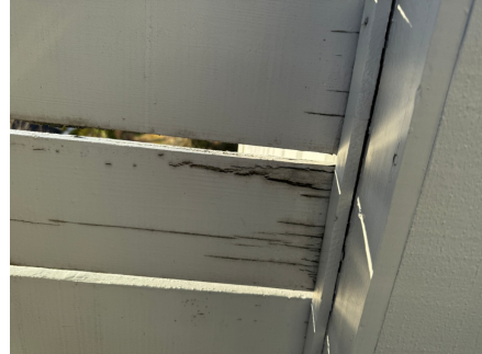
Værslitt trevirke for rekkverk. Må overflatebehandles.
