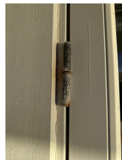
Irr/rust på hengsle til balkongdør
