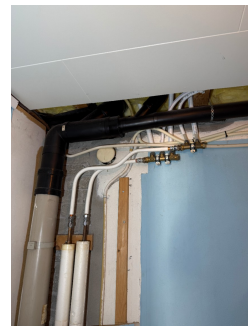
Uferdig overflater, vegg og himling
