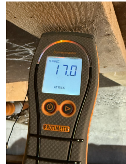
Fuktmåling i synlig trevirke, målinger viser over referanseverdier.
