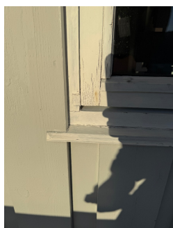
Omramming på vindu ligger tett på vannbrett beslag
