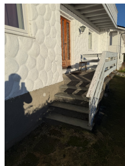
Støpt betongtrapp ved inngangsparti for underetasje. Understøtter har eternitt forskaling. Rustet innfesting for rekkverk.
