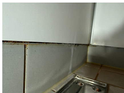
Misfarging og lite silikon i overgang mellom sokkelist og baderomsplate.
