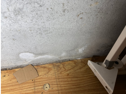
Tegn til saltutslag på nedre del av vegg sett fra bod.
