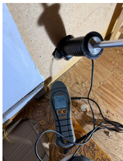
Fuktmåling i bunnsvill mot vaskerom
