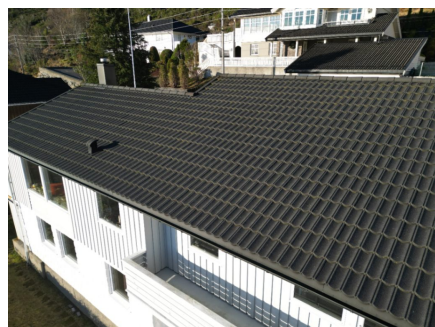
Det er ikke montert snøfangere på taket
