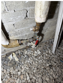
Stengeventil sett fra luftegraven
