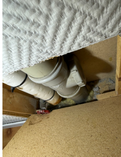
Stengeventil montert i vegg i gang underetasje.
