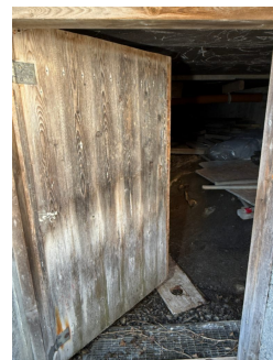
Luke/dør til krypkjeller. Bør overflatebehandles.
