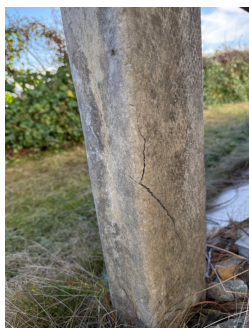
Eternittforskaling for understøtter til trapp har sprekker.
