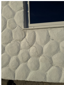
Sprekk/riss i murpuss ved vindu sørsiden.
