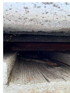
Ikke tegn til musebånd bak kledning.
