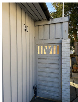
Nedløpsrør for takrennen er ikke tilkoblet.
