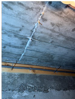
Avkalking i sprekk i betong sett fra luftegraven
