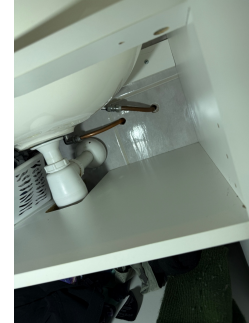
Manglende tetting rundt rørgjennomføring
