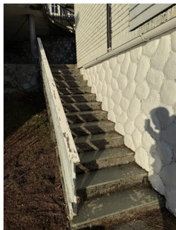
Utvendig betongtrapp med stein heller. Rekkverk av tre. Har behov for overflatebehandling. Betongtrapp
