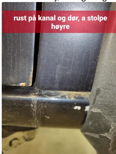
2.2 Korrosjon som har oppstått utifra normal slitasje. Kommer med kjørelengde og alder.
