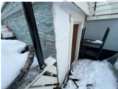
Alder, sprekker, skader og løsnede fliser.
