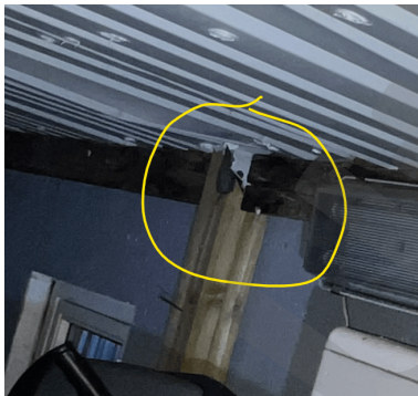
Under veranda. På avstand kunne det sees noe missfaring/råte på bjelke.
