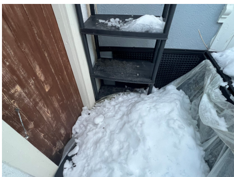
Stedvis mangler fuktsikring mot mur.
