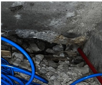
Rustflekker og saltutslag tegn på fuktvandring. Råte på treverk
