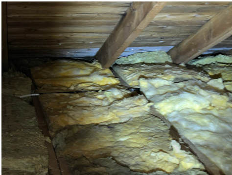
Muggmerker og frostrim etter kondens. Generelt fuktmerker i takkonstruksjon.
