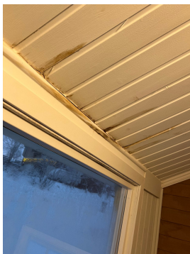
I vindfang er det fuktmerker i innvendig takoverflate.
