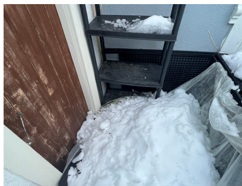
Stedvis mangler fuktsikring på mur.
