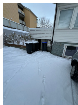
Stående vann ved varmepumpen.
