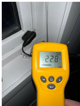
Fukt i treverk på vinduer og dugg på glass på innsiden
