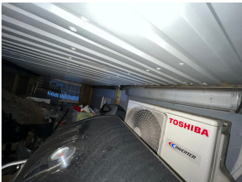
Vannoppsamlingsplater og takrenne virket ufagmessig montert.
