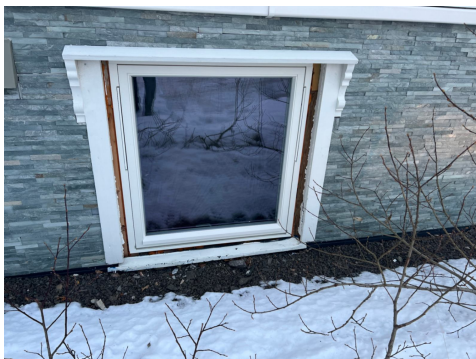
Stedvis mangler utvendig tetting/omramming.
