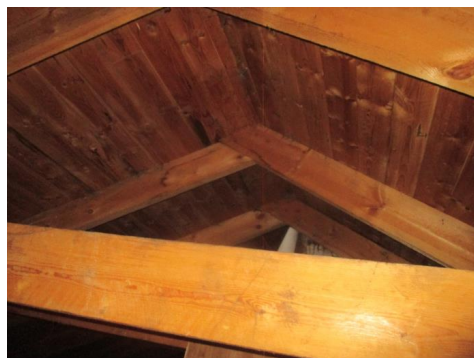
Noe misfarging av undertaket enkelte steder.
