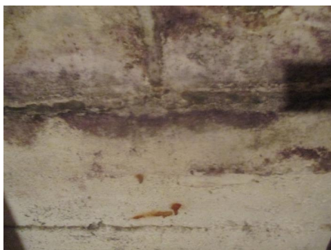
En del fuktmerker og fuktvandring.
