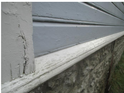
Bunnstokk i mot grunnmur.
