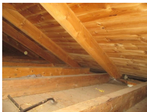
Ingen isolasjon i etasjeskille.
