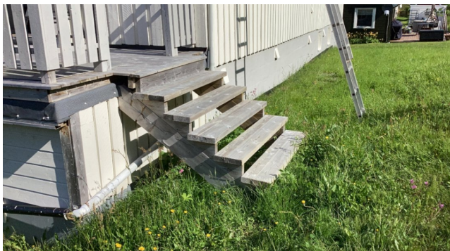
Fall inn mot grunnmuren
