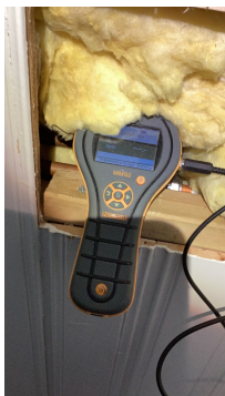
Målinger i trappe stikk i bjelke under nedslags feltet. ingen registreringer
