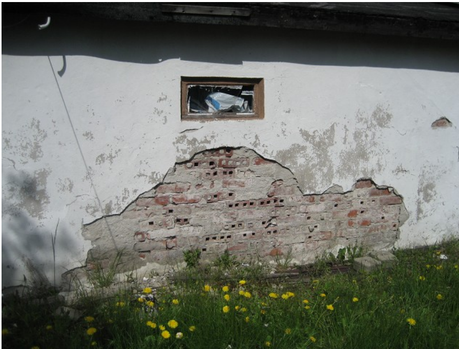
Avflassing på garasjevegg.
