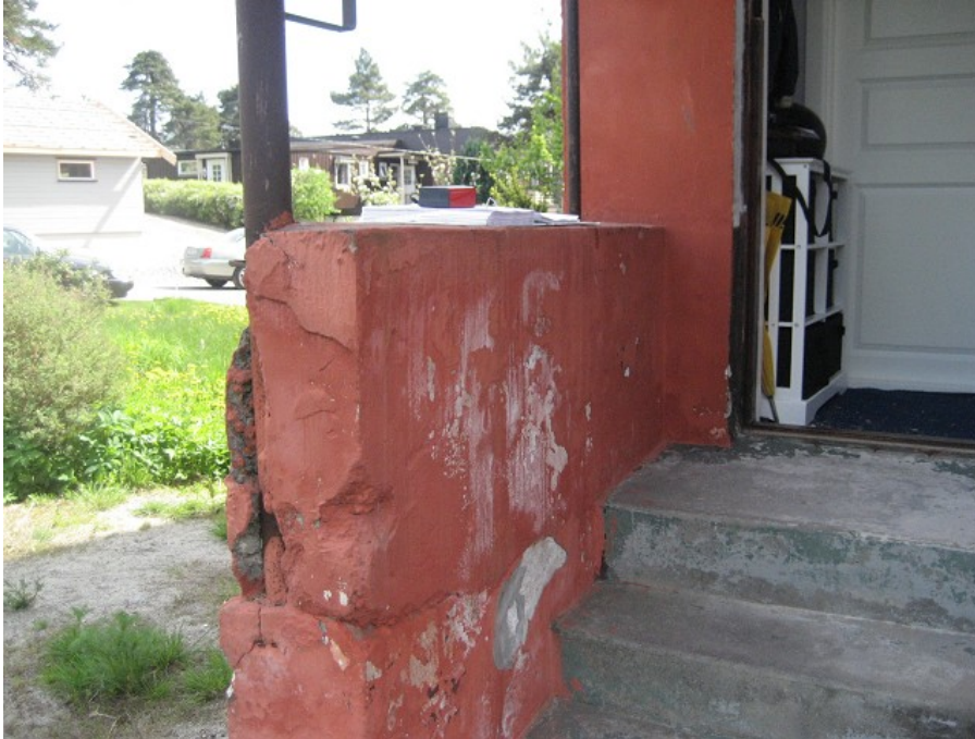
Murvange ved inngangstrapp. Skade.
