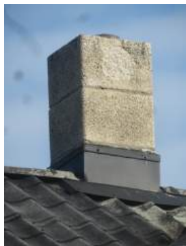
Upusset lettklinkerpipe over tak. Det ses å mangle avdekningsbeslag samt pipehatt.
