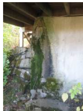
Fuktskaider som følge av takrennedløp - oppfukting av muren - frostskaider.
