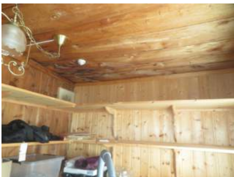
Vannmerker i himling inne i gang.
