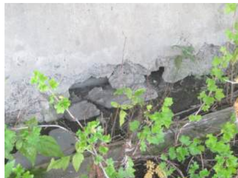
Skade med avskalling i murverket pga fuktopptrekk og frostskaider. Det ses benyttet tresonittplate utenpå muren - pusset overflate.
