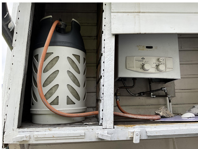
Varmtvannsbereder på gass fra 2007.
