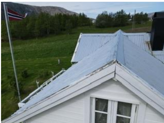
Vannbor har behov for vedlikehold eller utskifting.
