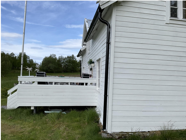
Sør-vest veggen viser stor skjevhet.
