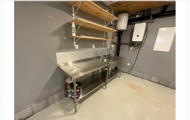
Arbeidsbenk med to kummer og arbeidsflate - utførelse av stål. Plassert i garasjerom.
