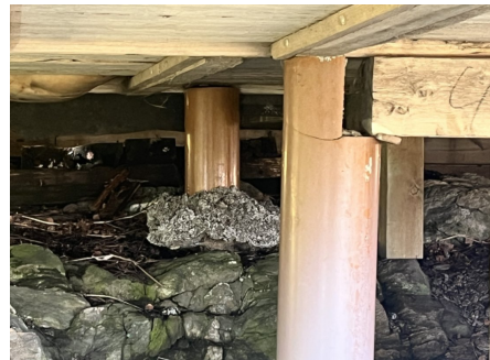
Betong lagt på løsmasser som er vasket vekk.
