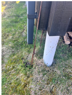
Vann fra nedløp ledes ikke bort fra bygningen
