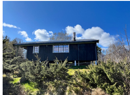
Ikke stigetrinn på tak
