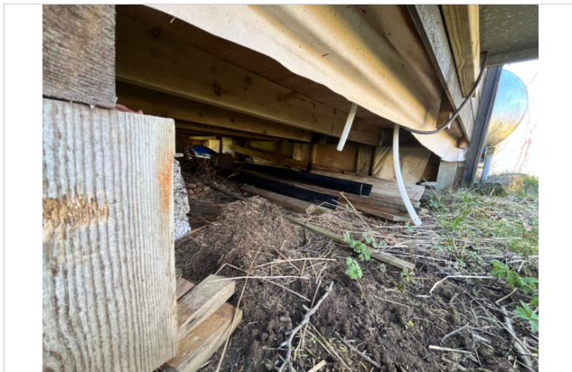
Uferdig , ikke klemlakte på vindsperre
