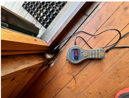
Fukt i bunn på dør til den eldste delen.
